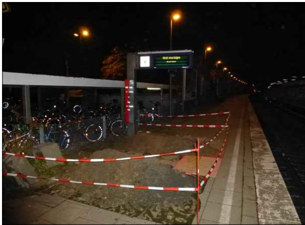
Abbildung 49: Am S-Bahnsteig Gleis 1 in Pinneberg war die Notruf- und Infosäule durch eine Baustellenabspernung nicht erreichbar.
