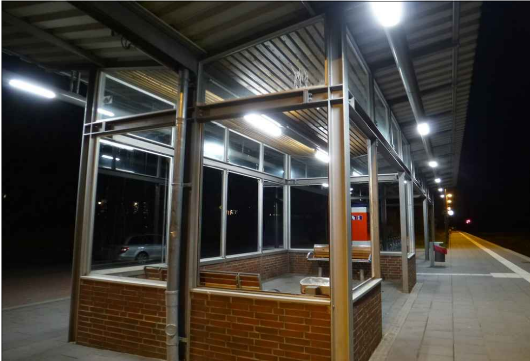
Lensahn: Haltepunkt an der Strecke Lübeck - Puttgarden: Sechs der zehn großen Scheiben in der Wartehalle fehlten. Zusätzlich waren zwei der oberen Scheiben beschädigt. Auch der Fahrkartenautomat war defekt.
