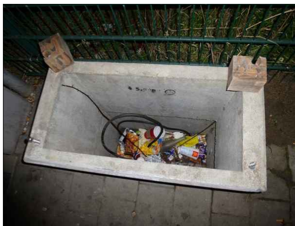
Abbildung 14: Die fehlende Abdeckung dieses ungenutzten Automatensockels in Bad Oldesloe ermöglicht den Missbrauch als Müllbehälter.
