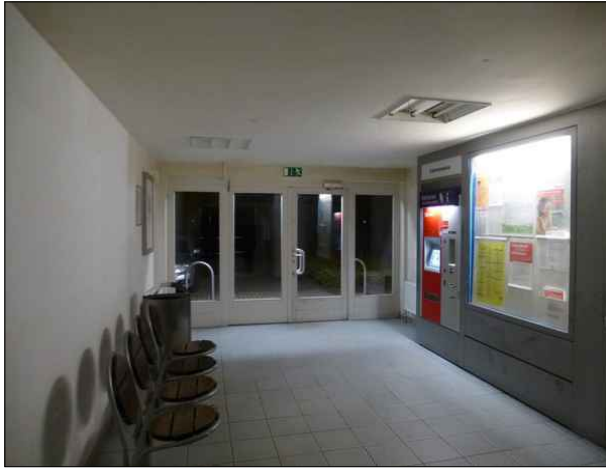
Abbildung 34: Der Warteraum im Empfangsgebäude von Haffkrug war nur durch die Vitrine beleuchtet. An einer Deckenlampe fehlte zudem die Abdeckung.
