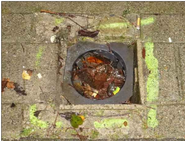
Abbildung 4: Mitten auf dem Hausbahnsteig in Meldorf fehlte ein Gullideckel.
