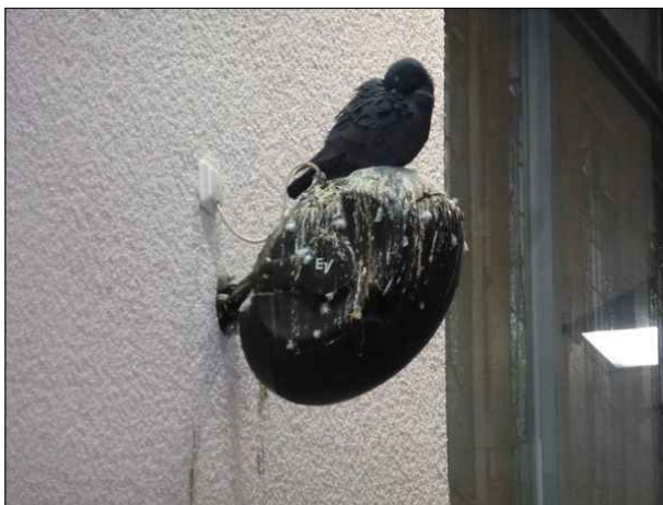
Abbildung 36: Die an den Wänden der Eingangshalle des Hauptbahnhofs in Lübeck installierten Lautsprecher sind durch Taubenkot stark verschmutzt.
