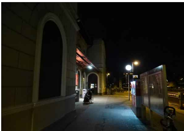
Abbildung 45: Die nicht funktionierenden Strahler an der Fassade des Bahnhofsgebäudes von Bargtheide beeinträchtigen den Zugang und die Lesbarkeit der Aushänge.
