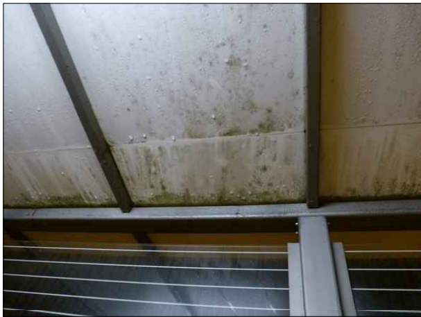
Abbildung 8: Die Dächer der älteren Unterstände in Niebüll sind weiterhin undicht und stark verschmutzt.
