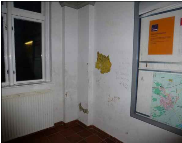
Abbildung 35: Die sichtbaren Feuchtigkeitsschäden an den Wänden im Warteraum des Gebäudes in Burg (Dithm.) beeinträchtigen neben der defekten Beleuchtung, beschädigten Scheiben und einigen Kritzeleien den Wartekomfort.
