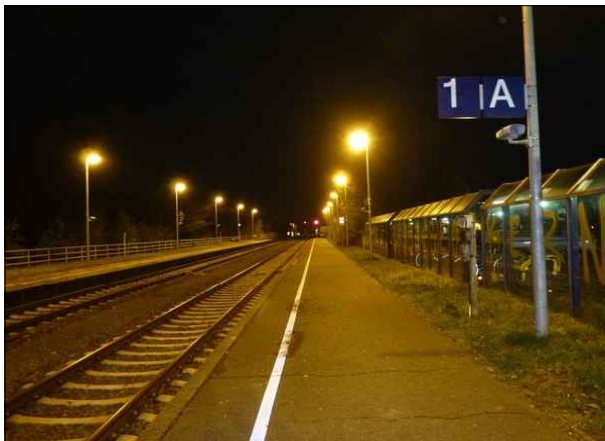
Abbildung 16: An Gleis 1 in Eckernförde wurden im Außenbereich neue Gleisabschnittsschilder installiert. Ein Nutzen dieser Aktion ist nicht erkennbar.
