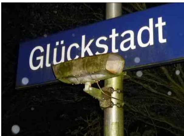
Abbildung 27: In Glückstadt sind an Gleis 2 weiterhin einige Lautsprecher stark verschmutzt.
