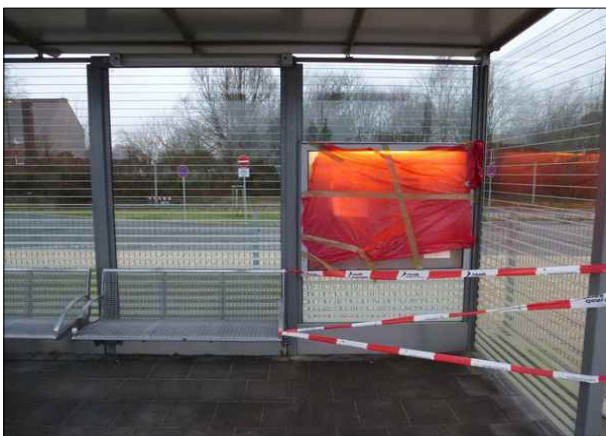
Abbildung 24: An Gleis 1 in Heide war eine Vitrinenscheibe zerstört.
