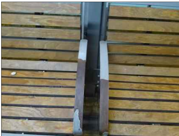
Abbildung 11: Die Bereiche abplatzender Beschichtungen an den Bänken an Gleis 4 in Büchen werden größer.
