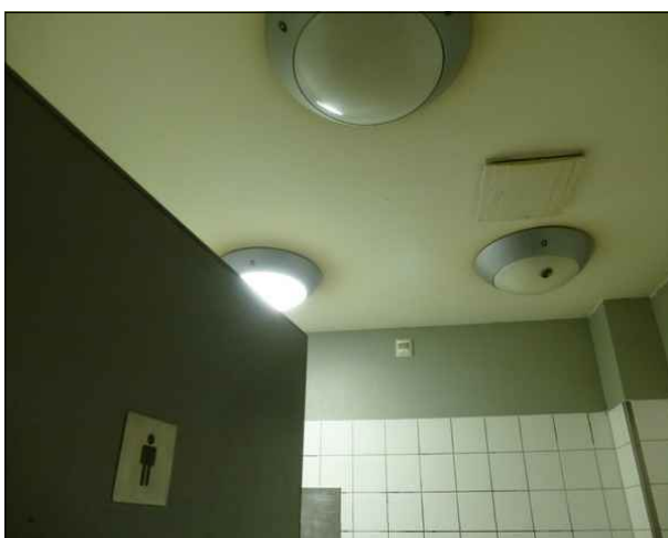
Abbildung 39: Im Herren-WC am Bahnhof Reinbek waren zwei der drei Lampen defekt.
