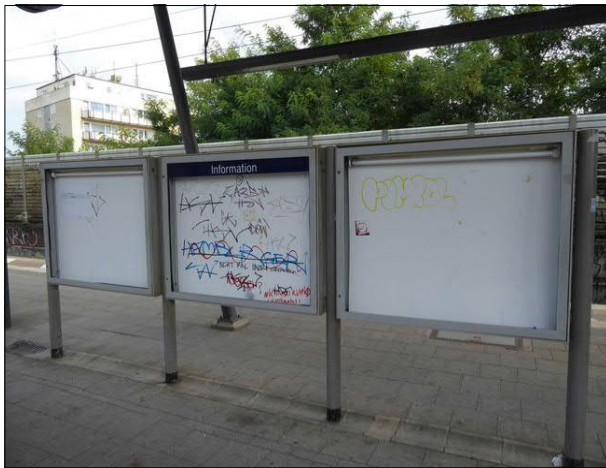
Abbildung 22: In Hamburg-Tonndorf waren bereits im 1. Quartal 2024 sechs Vitrinenscheiben zerstört oder fehlten. Bis zur Erhebung im 3. Quartal wurden diese Schäden nicht behoben.
