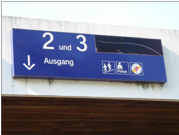
Abbildung 27: An mehreren Stationen wirken die Informationen auf den Wegeleitungsschildern zu den Bussen und zum SEV verschmutzt. In Elmshorn an Gleis 1 ist es extrem. Es scheint sich aber um Materialschäden zu handeln.
