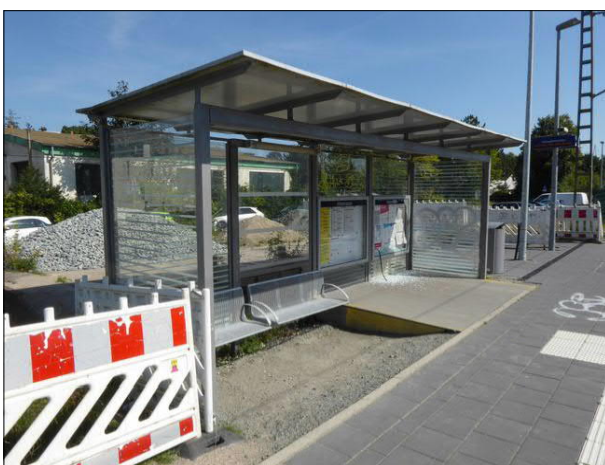
Abbildung 14: In Jübek an Gleis 2 wurde der Bahnsteig bereits im Jahr 2023 mit 76 cm Höhe über der Schienoberkante erneuert. Der Unterstand wurde bis zum Herbst 2024 noch nicht an die neue Bahnsteighöhe angepasst.
