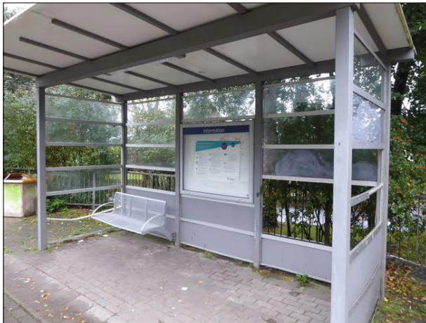
Abbildung 16: Der Unterstand in Krempe an Gleis 2 wies bei allen Erhebungen große Schäden auf. Zu erkennen sind auch die einzelnen flächig zerkratzten Kunststoffscheiben.
