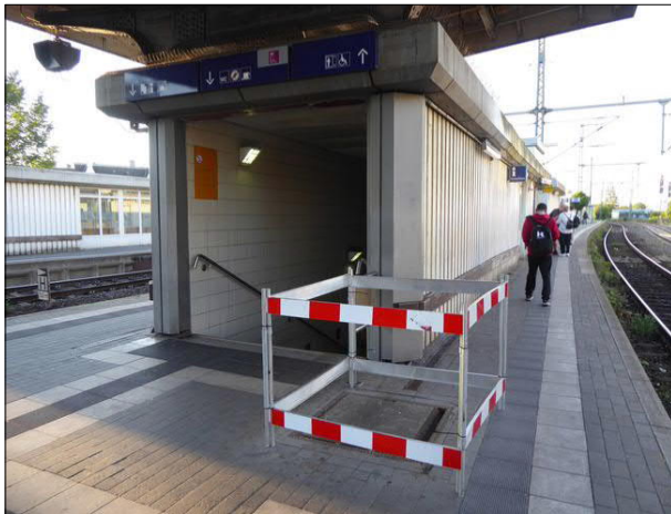
Abbildung 9: In Neumünster gab es auf den Bahnsteigen wiederholt Absperrungen rund um schadhafte Schachtdeckel. Direkt am Treppenaufgang und direkt am Blindenleitstreifen sind das Engpässe für die Fahrgäste.
